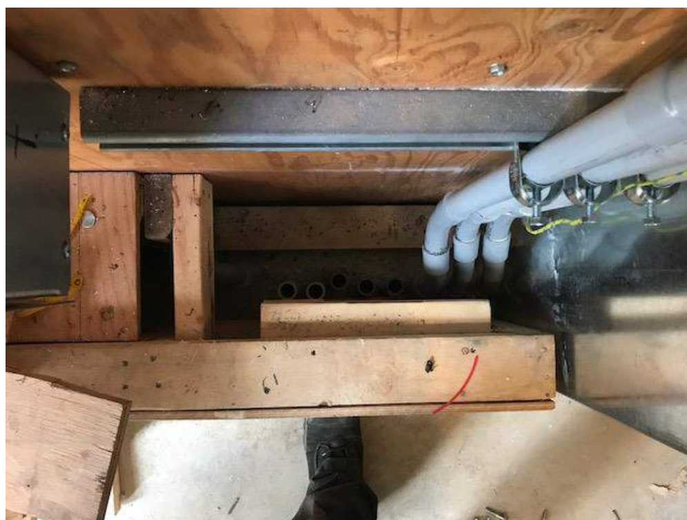
Empty conduit system ORIGINAL TARGET
