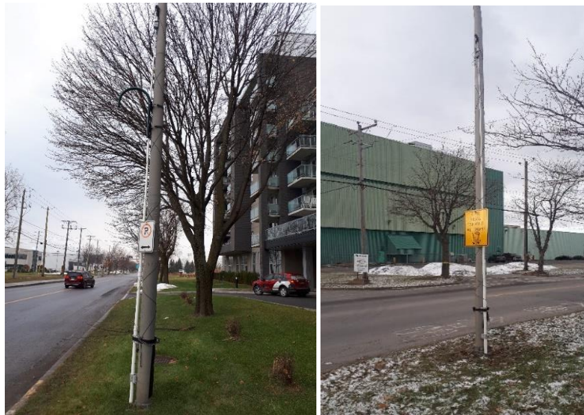
Figure 10 : Installation typique à Candiac sur le boulevard Montcalm
